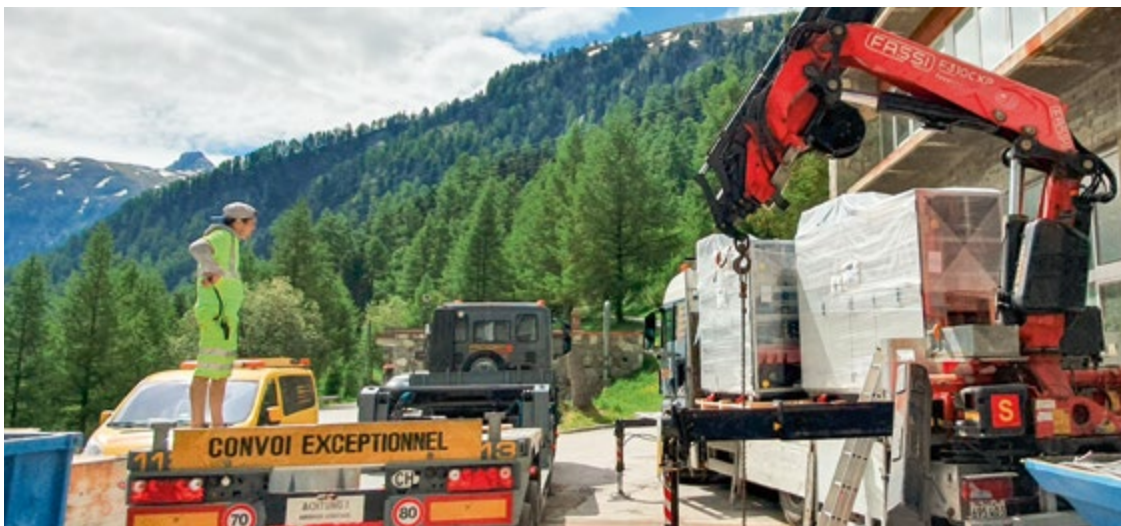
— Der neue Frequenzumrichter wurde Ende Mai in die hochalpine Pumpstation geliefert.
