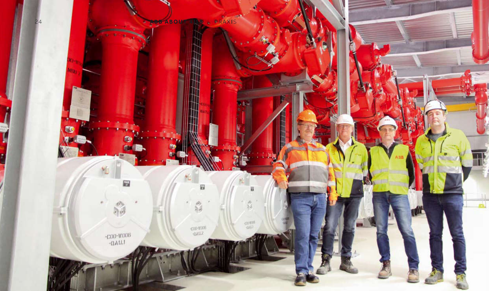
Das Projektteam vor der gasisolierten Schaltanlage in Châtelard v. l. n. r.: Sjoerd Bearda (ABB), Heinz Krauer (Swissgrid), Fabio Paglia (ABB) und André Grangier (Swissgrid).
