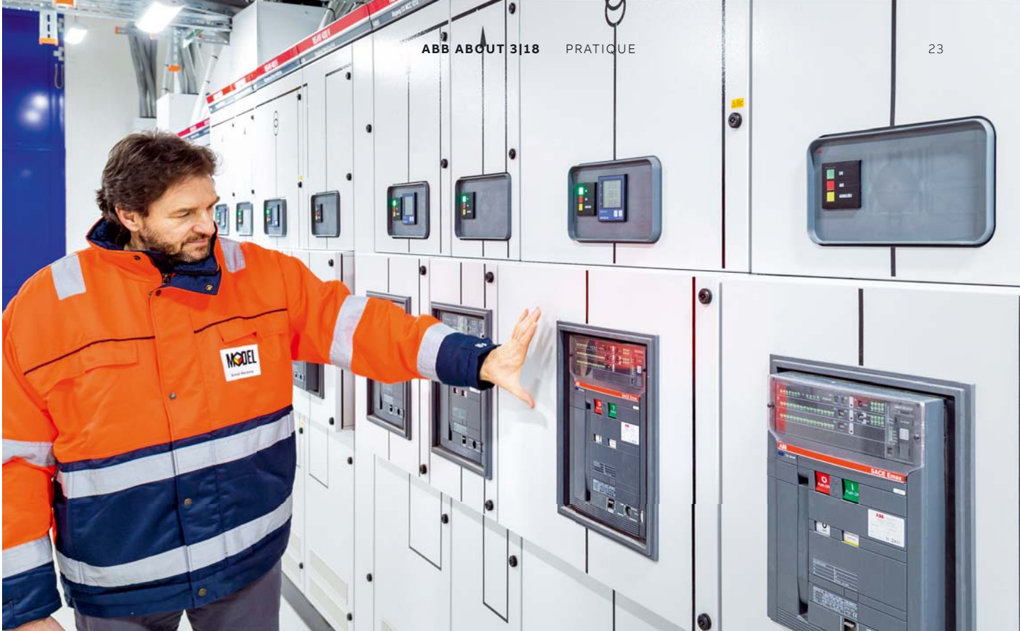
— Ernst Herzog devant l'installation de distri- bution basse tension de type MNS 3.0.
