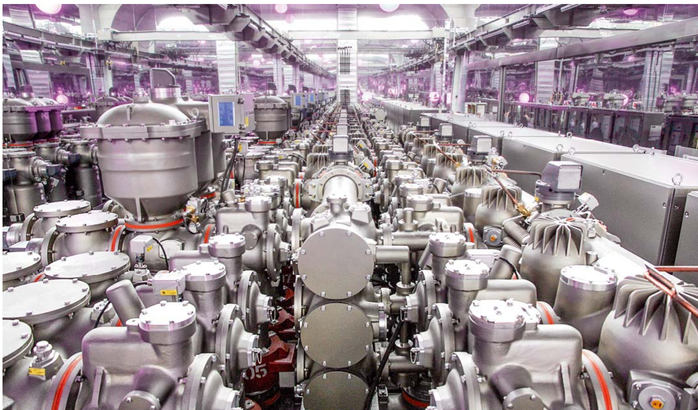
Durch die Spiegel an der Wand wirkt die gasisolierte Schaltanlage endlos, obwohl sie auf engstem Raum installiert wurde.
