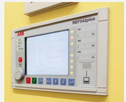
Eines der über 500 installierten REF542plus, hier in einer ZX0-Mittelspannungsschaltanlage.
