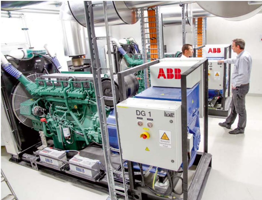
Marc Bernhard (rechts) und Peter Wagner bei den beiden Netzersatzanlagen für Bethesda.
