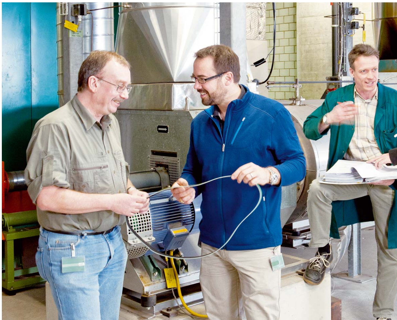
Bernd Nafz, Raoul Tanner, Roman Ackeret und Andreas Kreienbühl in der Lüftungsanlage von Habasit in Reinach (v. l. n. r.).
