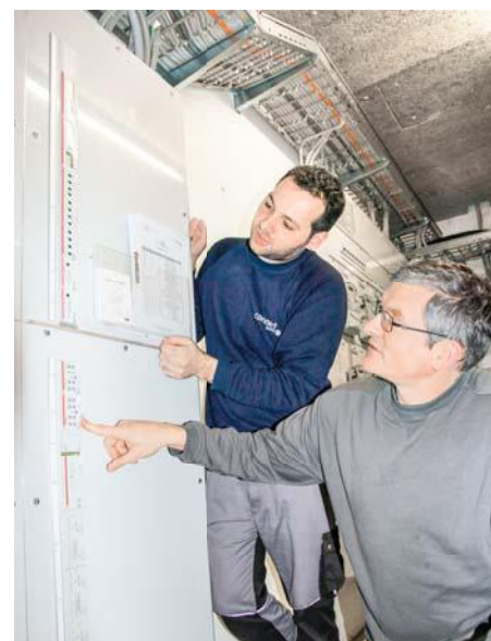
Christian Bardet von SACAO (rechts) und Jérémy Lecoutre von Groupe E Connect beim Schaltschrank für die Gebäudeautomation des Quadrant.
